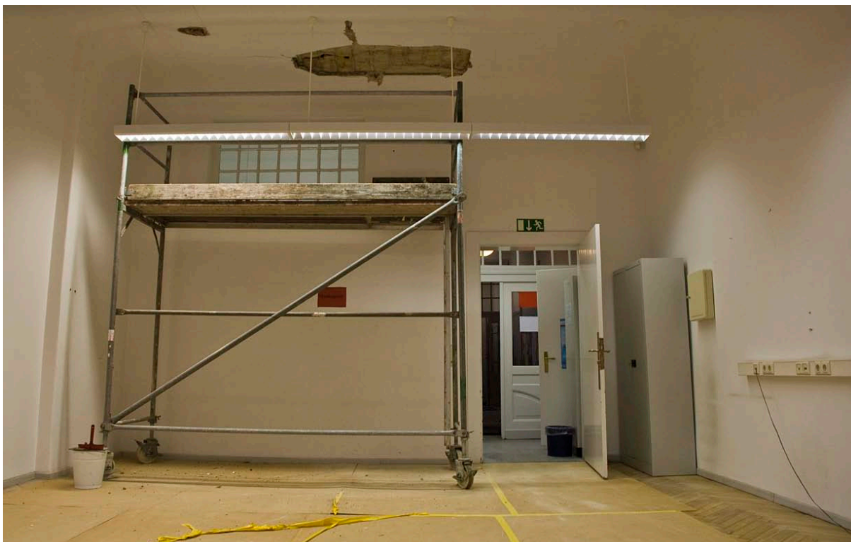
Das Historische Institut am historischen Campus in der Domstraße musste gesperrt werden, nachdem Putz von der Decke geplatzt war.
